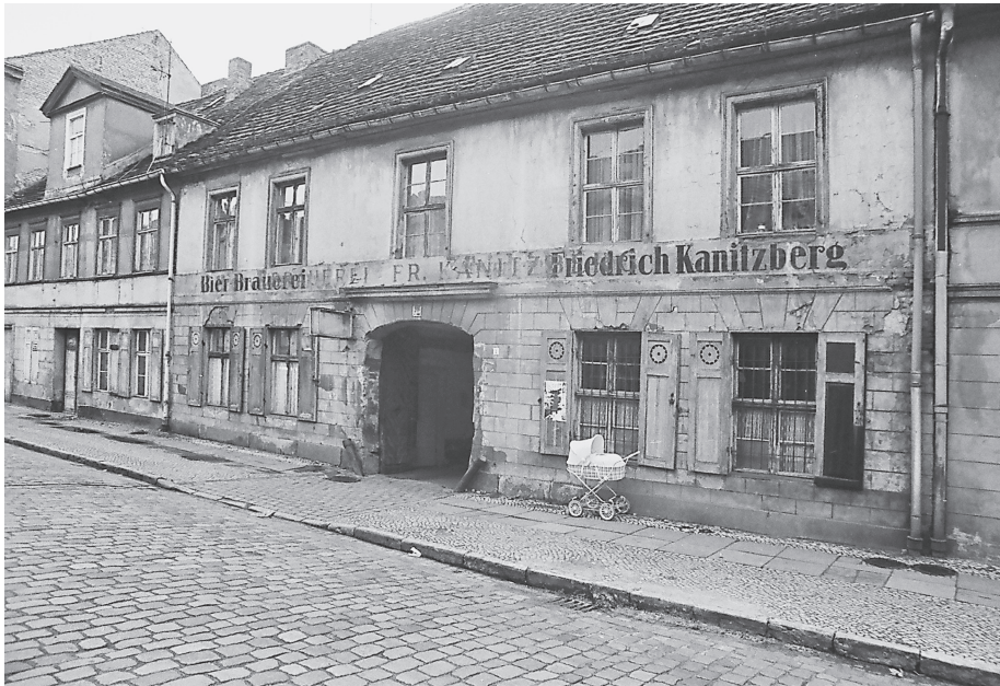
Zerfallende Altbausubstanz in der Hermann-Eflein-Straße, nur wenige Meter von der zentralen Einkaufsstraße Potsdams und vom Holländischen Viertel entfernt.
