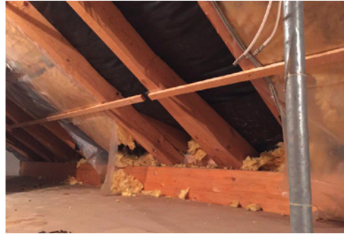
Dachschaden! Manche Steinmarder treiben Hausbesitzer in den Wahnsinn. Besonders gerne toben sich die Tiere in den leicht zerlegbaren Dämmmaterialien wie Steinwolle aus.
